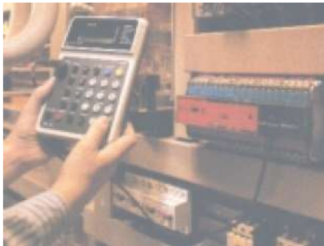
Εικόνα 3.10: Ανίχνευση βλαβών σε εγκατάσταση PLC.
