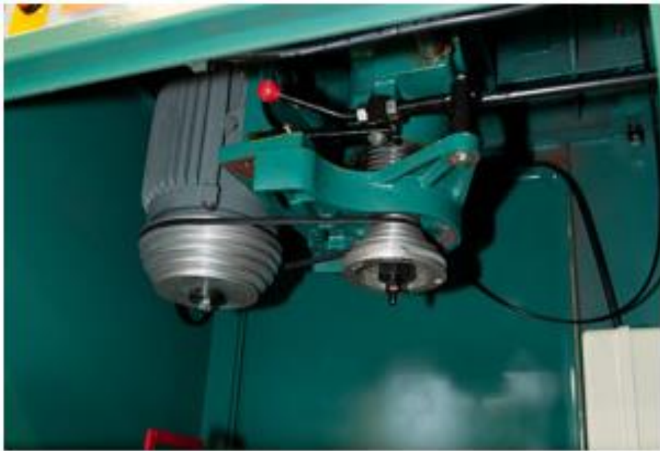
Σχ.4.2.3 Ηλεκτρική κίνηση στον ανεμιστήρα εξάτμισης του εργαστηρίου.
