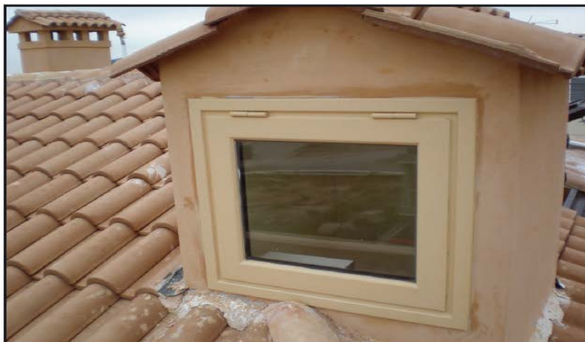
Εικόνα 4: Εφαρμογή αιολικής καμινάδας, στη βιοκλιματική κατοικία Μισσιακού, 240m 2 , στην Παιανία Αττικής. Η θυρίδα ανοίγει εσωτερικά με ντζία. Στην κατοικία υπάρχει και ηλιο-γεωθερμικό σύστημα θέρμανσης νερού και χώρων (Κ. Τσίππρας, 2009).
