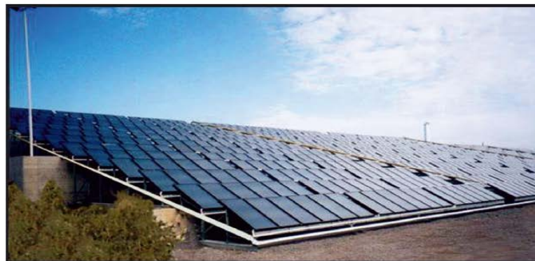
Εικόνα 3: ΨΒ-Ηλιακό σύστημα ηλιακής ψύξης ετοιμών προϊόντων στο εργοστάσιο καλλυντικών Σαράντης ΑΕΒΕΕ στα Οινόφυτα Βοιωτίας ολικής συλλεκτικής επιφάνειας 2.800 m 2 και ψυκτικής ισχύος 700 kW [ΛΕ Α.Ε., 2004, www.sole.gr].
