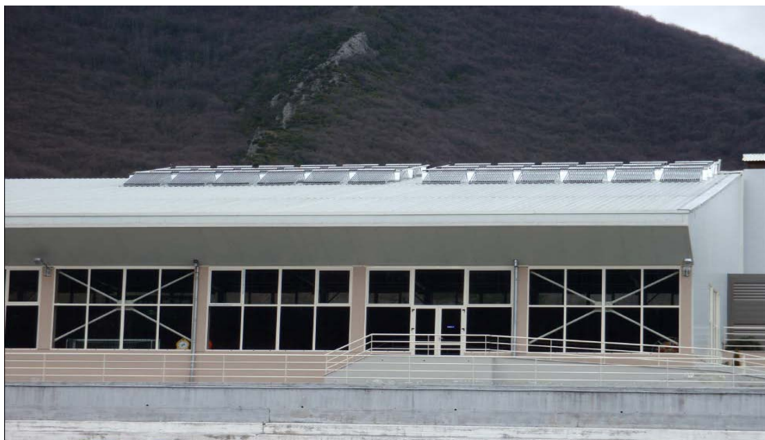
: Θέρμανση της πισίνας του Δημοτικού κολυμβητηρίου στον Δήμο Νάουσας με ηλιακό σύστημα ολικής συλλεκτικής επιφάνειας κενού 115 m 2
