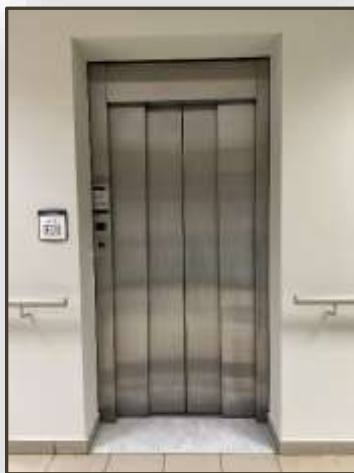
Εικόνα 78. Ανελκυστήρας (Ε.Ε.Ε.Ε.Κ. Ηρακλείου Αττικής)
