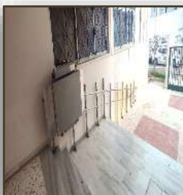
Εικόνα 96. Αναβατόριο κλίμακας με πλατφόρμα (6 ο ΓΕ.Λ. Ιλίου)
