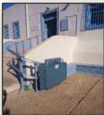
Εικόνα 95. Αναβατόριο κλίμακας με πλατφόρμα (3 ο Γυμνάσιο Καλύμνου)
