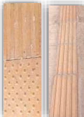
Εικόνα 23. Επιδαπέδια σήμανση (1 ο Γυμνάσιο Λαυρίου)
