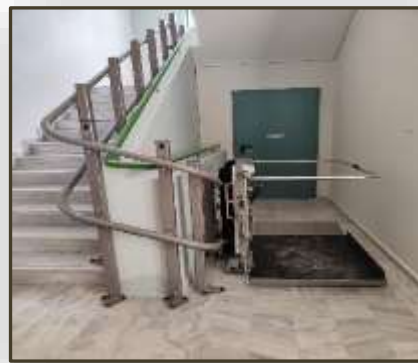
Εικόνα 19. Αναβατόριο κλίμακας με πλατφόρμα (Ειδικό Δημοτικό Ζεφυρίου)
