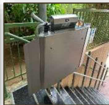
Εικόνα 100. Αναβατόριο κλίμακας με πλατφόρμα (5 ο Δημοτικό Σχολείο Νέας Σμύρνης)
