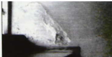
(α) Βλάβη επιχρίσματος (αποφλοίωση)
